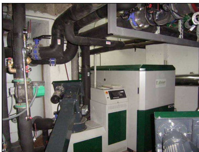
Figura 4. Caldera de pellets en comunidad de vecinos. Foto: Eolimer Renovables, S.L..
