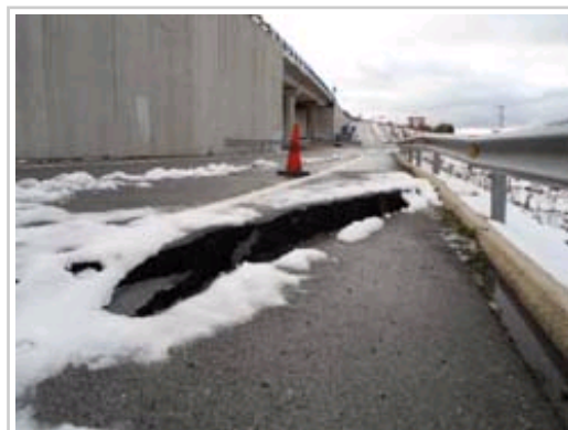
Estado en el que se encontraba la calzada.
